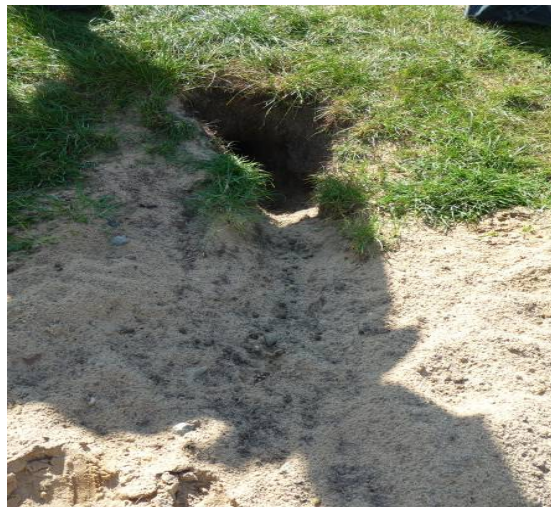
Wühltierschaden auf der Binnenseite des Lohmandeiches
